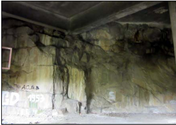
Abbildung 16: feuchte Felswand im Werksgebäude mit Versteckmöglichkeiten
