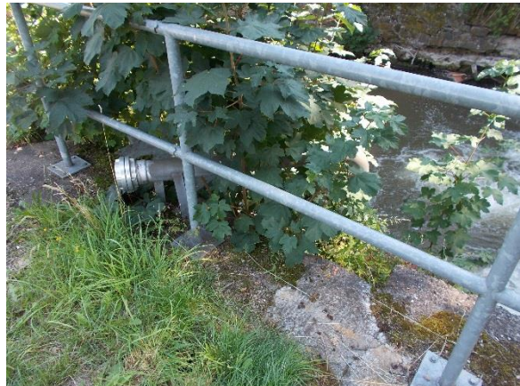
Löschwasserentnahme im Unterwasser links des Wehres
